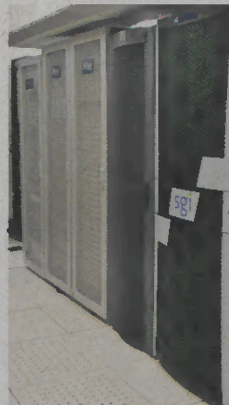
Infraestrutura do Centro de Supercomputação da UFRGS (CESUP) oferece serviços de processamento para áreas de ensino e pesquisa do todo o país
